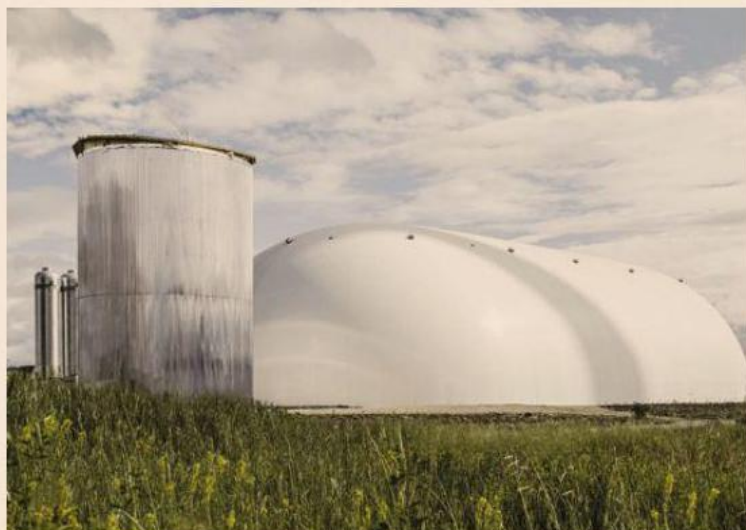
Energy Dome. La società ha un impianto pilota a Ottana, in Sardegna
